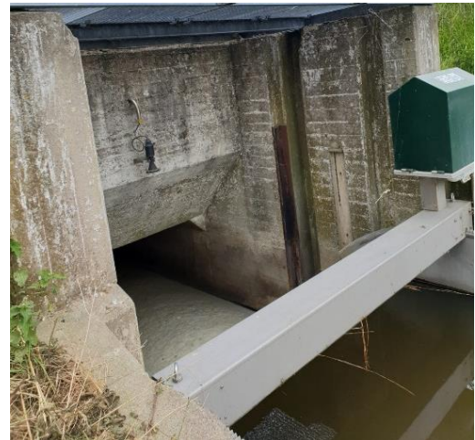
Figuur 19, KDU-740 voorzien van geautomatiseerde klepstuw
